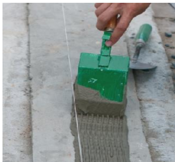
Dùng bay răng cưa trát vữa xây theo chiều dài mặt liên kết gạch.
