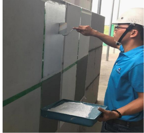
Thi công trực tiếp sơn nước (sơn lót và sơn hoàn thiện) lên bề mặt của skimcoat EBS-300).
